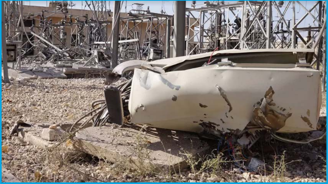
أضرار إثر قصف القوات الروسية محطة خان شيخون لتحويل الكهرباء في قرية كفر عين/ إدلب 21 / 9 / 2017
