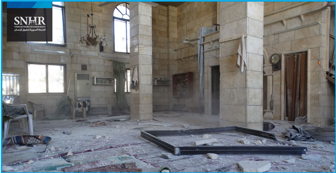
أضرار إثر قصف قوات النظام السوري مسجد الرحمن وسط قرية البارة/ إدلب 5/ 4/ 2018
