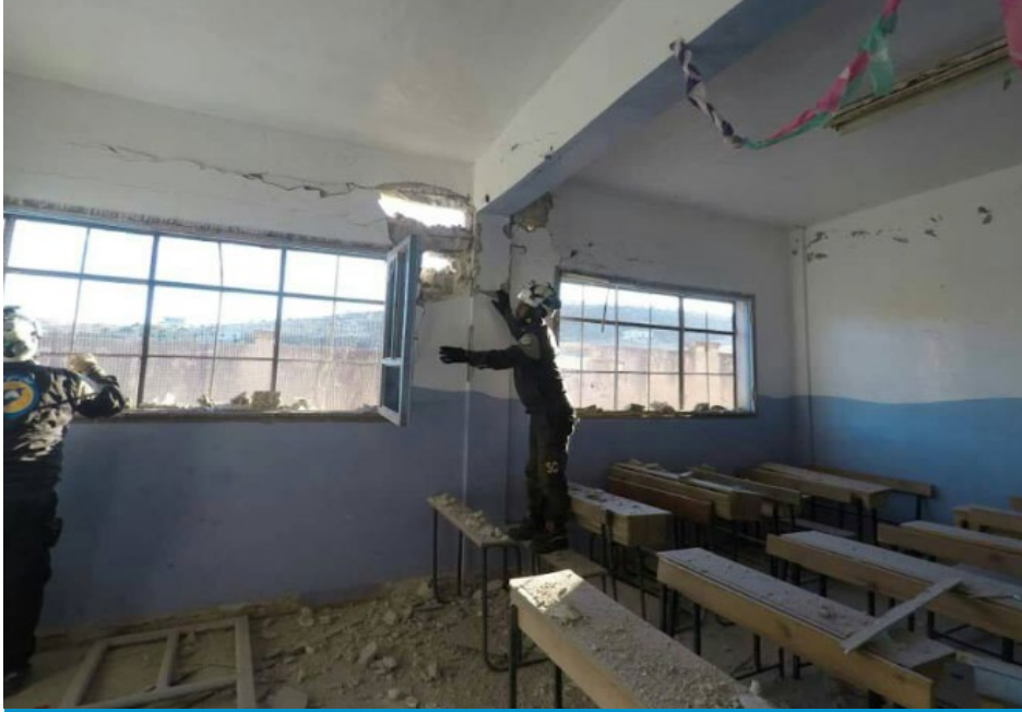
أضرار إثر هجوم أرضي لقوات النظام السوري على مدرسة عائدون في قرية حورته/ حماة - 28/ أيلول/ 2019
