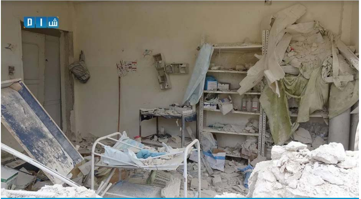
الدمار الذي لحق بمركز الهبيط للرعاية الصحية الأولية إثر هجوم أرضي لقوات النظام السوري على قرية الهبيط/ إدلب - 30 نيسان/ 2019
